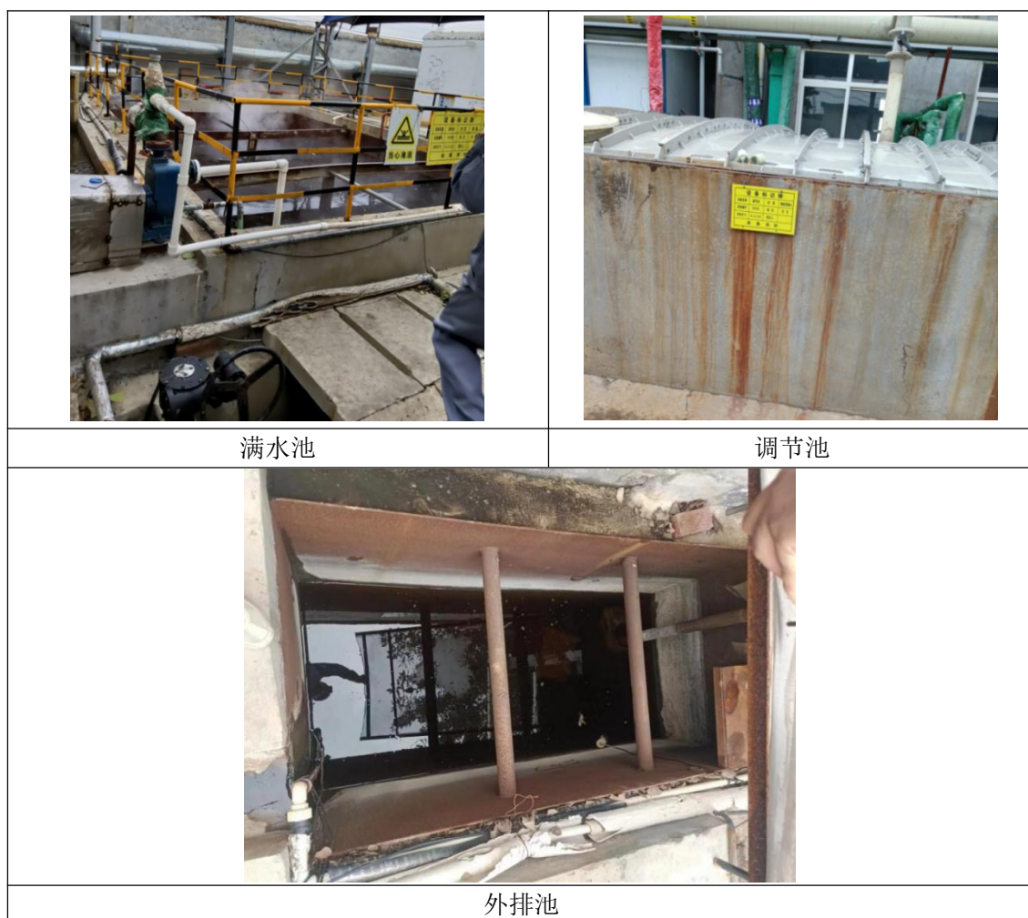
图 4.3-2 污水处理站实际情况
